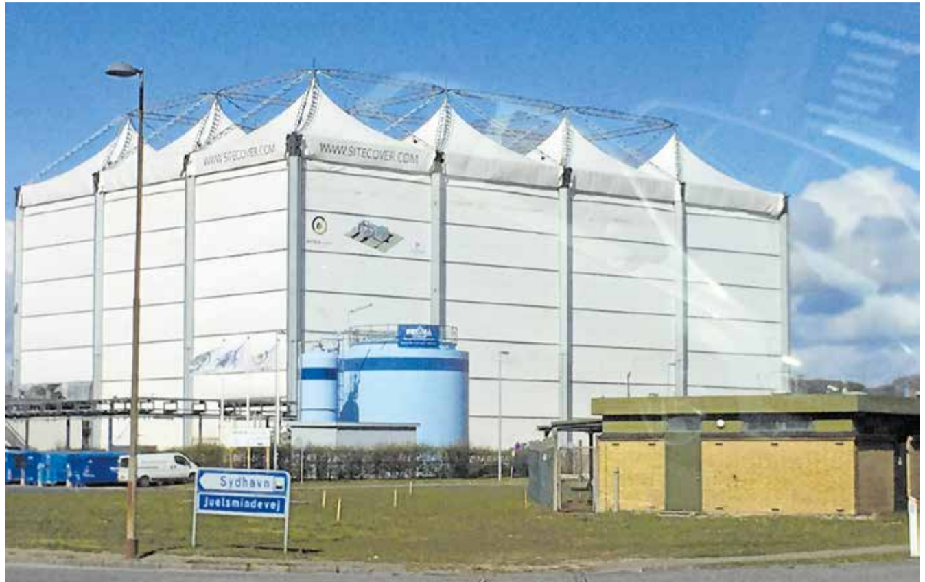
Her ses den byggeplads i Kalundborg, som West Presennings har sørget for den kæmpe overdækning af.
